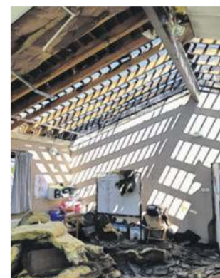
Les dégâts dans le bâtiment JP3 après l'incendie du centre de loisirs.
